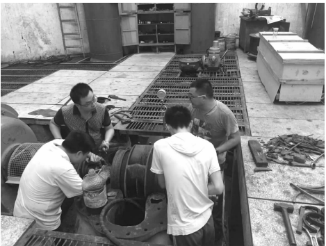
8月2日,凉亭山水厂江边混水2号泵揭盖清理杂物排除故障。 胡运强 摄
